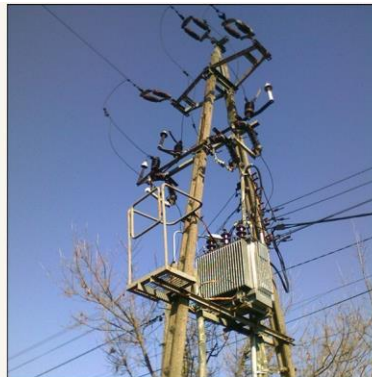
napowietrzna stacja transformatorowa 15 kV/0,4 kV
